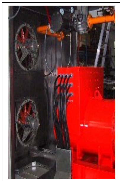
Particolare della ventilazione all'interno della sala motore
