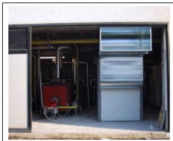
Vista dall'esterno della centrale termica con particolare del convogliatore di aerazione del cabinato
