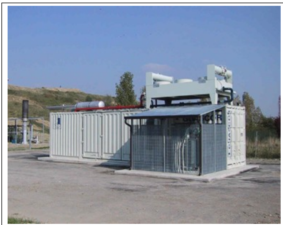
Vista d'insieme ove si nota la cabina esterna con il trasformatore di tensione in bagno d'olio.
