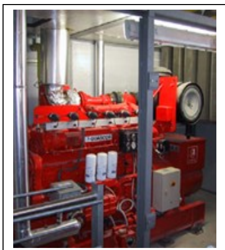
Particolare installazione motore all'interno del cabinato
